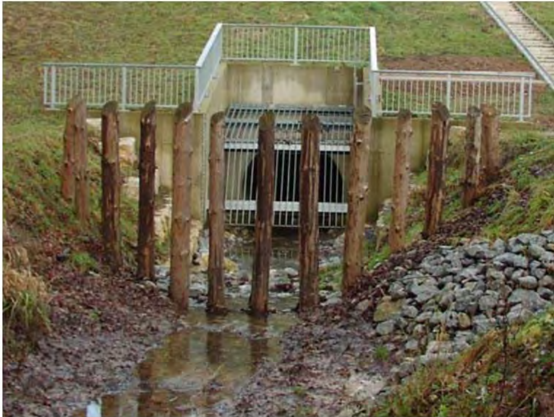
Treibgutsperre aus Holzpfählen vor Rohrdurchlass
